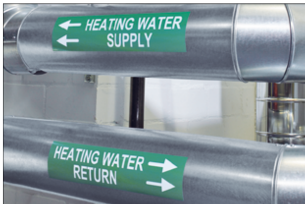
Stort og synlig merking av rør.
