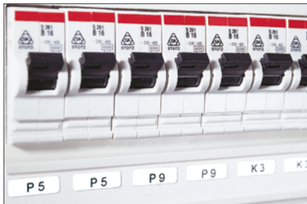
Tydlig og permanent merking av tavler.
