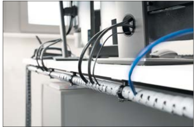
Helawrap - for kabelføring i kontormiljø.
